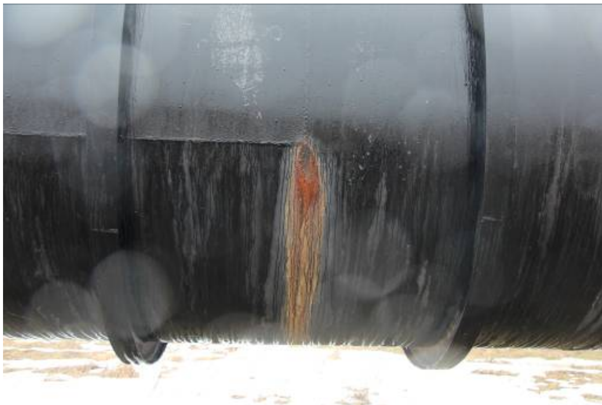
Рисунок 7 - Место образования дефекта снаружи дюкера
