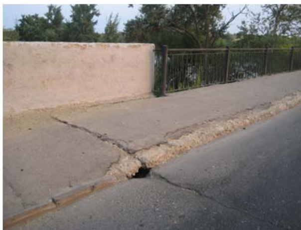
Рис. 1 – Разрушение ригеля, карнизной конструкции и бетона пешеходной части моста
