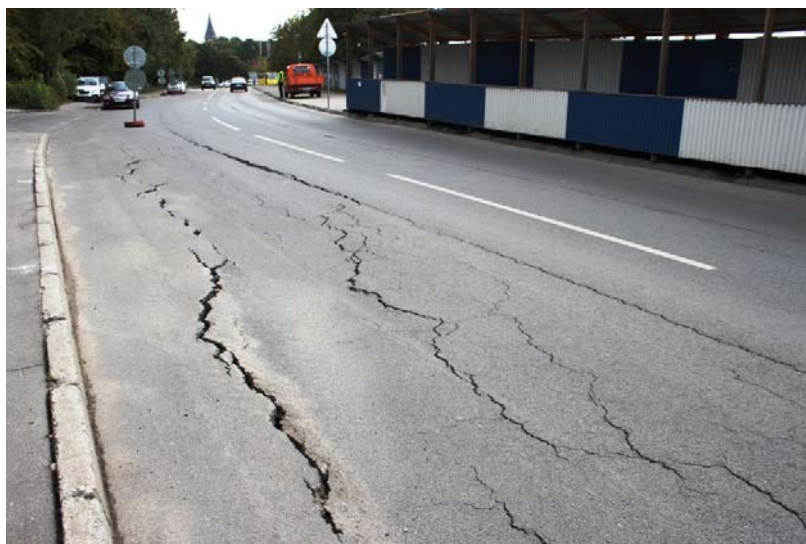
Рис. 2. – Поверхностная колея на покрытии, сопровождаемая просадкой асфальтобетона
