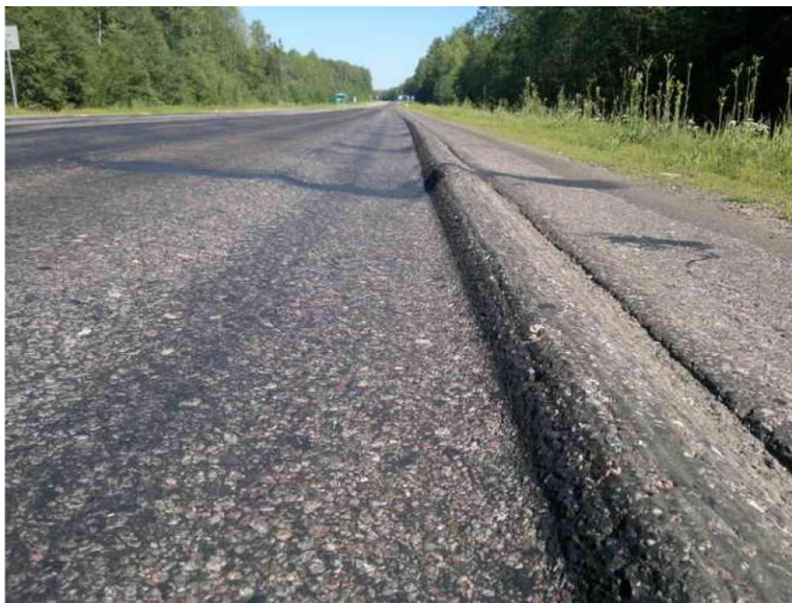
Рис. 1. – Поверхностная колея на покрытии, сопровождаемая выпором асфальтобетона
