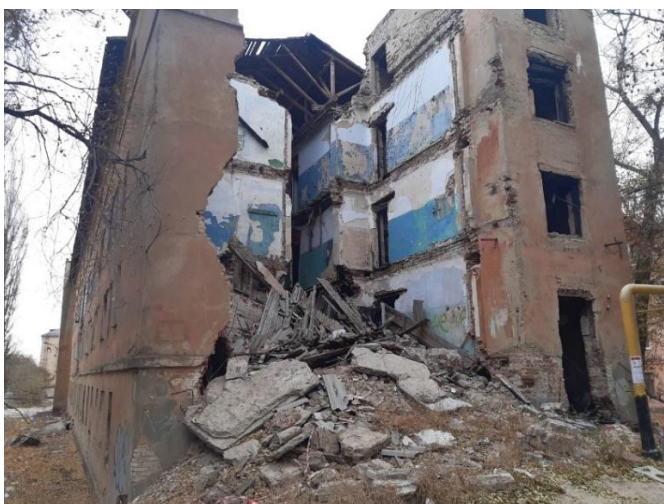
Рис. 2. - Обрушившееся общежитие тракторного завода по адресу: улица Жолудева, д. 20
