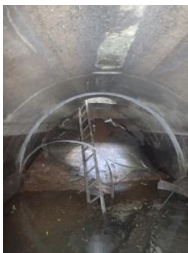
Рис. 2 Разрушение боковой стенки с последующим выходом грунта
