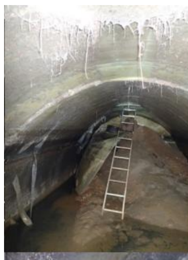
Рис. 3 Разрушение боковой стенки емкости с последующим выходом грунта, расслоение корпуса
